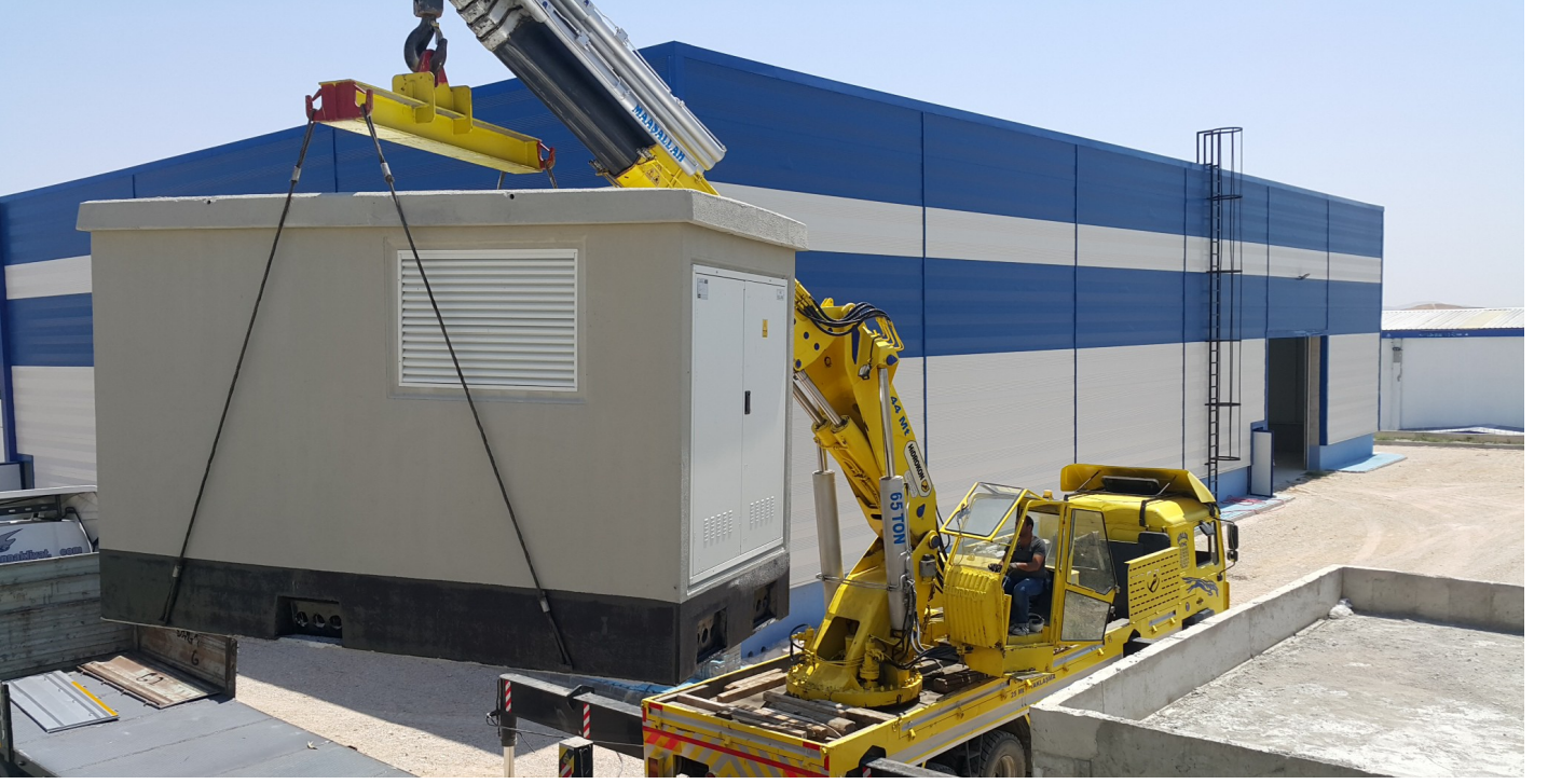
O.G. Trafo Merkezi
